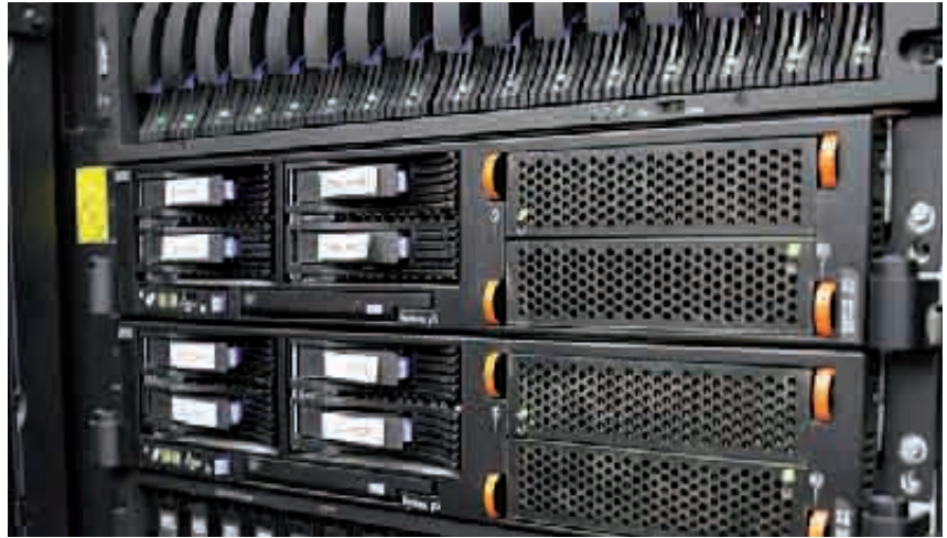
Los servidores de discos de Magerit almacenan más de 192 TB de información en alta disponibilidad, con tolerancia a fallos y conectados con una red de alta velocidad y baja latencia.
